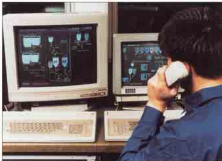
Bild 12: Steuerwarte einer Sandaufbereitungsanlage
